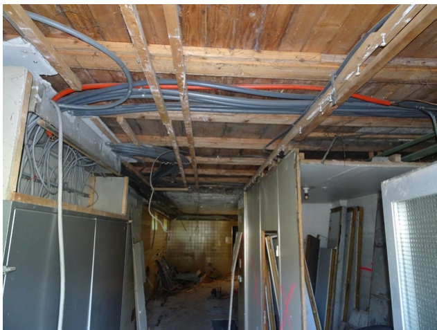
Plafond avant reinforcement
