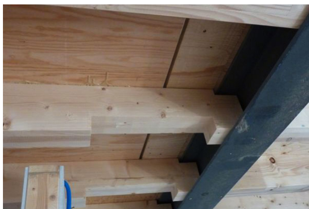
Découpes pour les installations techniques dans les éléments nervurés des plafonds d'étage
