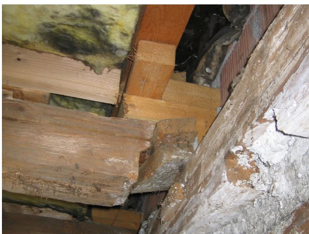
Support de poutres OG avant la rénovation
