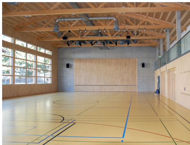
Suffisamment de place pour les tuyaux de ventilation grâce à la construction en treillis
