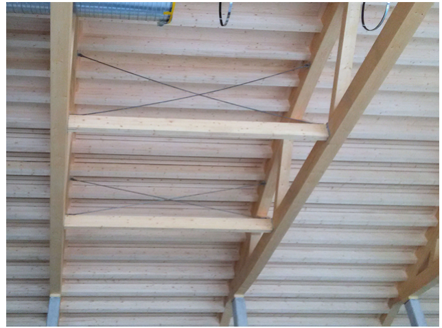
La construction stabilisante absorbe les forces des équipements sportifs
