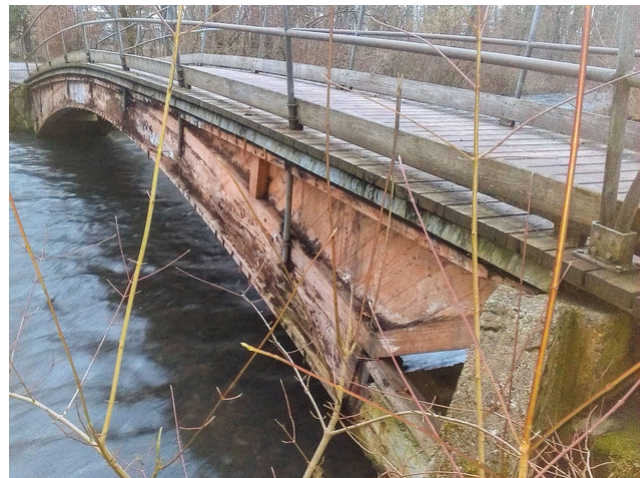
Musste dringend ersetzt werden: die alte Fußgängerbrücke
