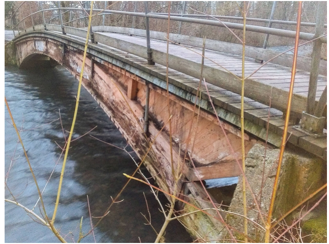
Musste dringend ersetzt werden: die alte Fußgängerbrücke
