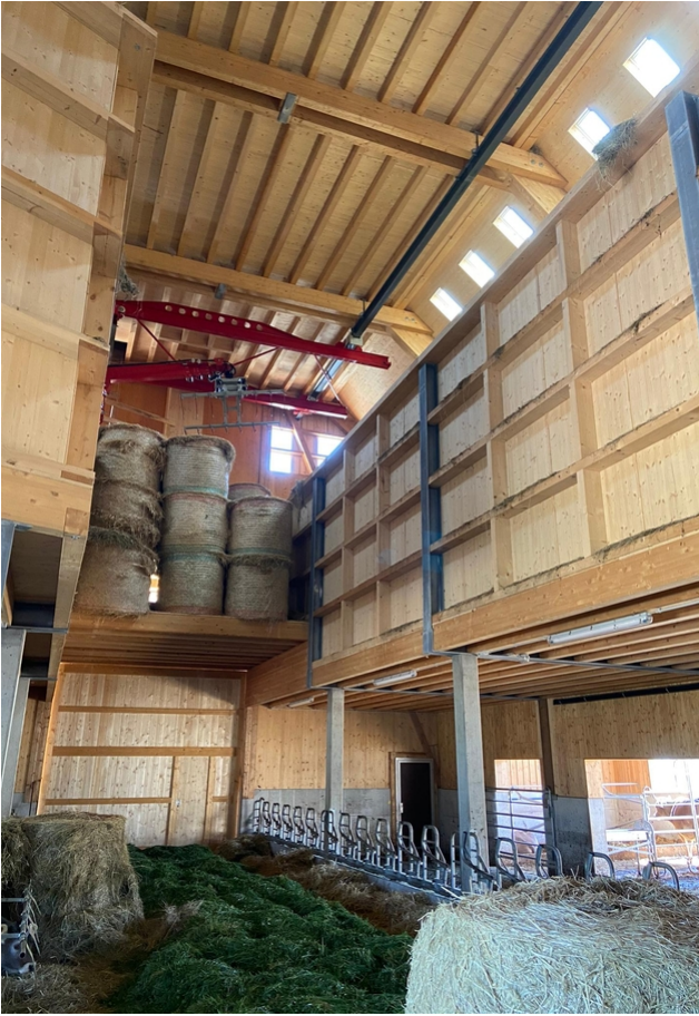
Aufhängung Heukran in der Scheune
